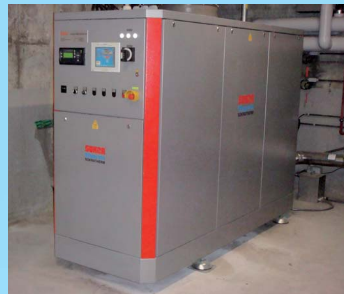
Das im Alters- und Pflegeheim Lindenstrasse installierte Blockheizkraftwerk wird mit Erdgas betrieben und produziert 82 kW Wärmeleistung.
