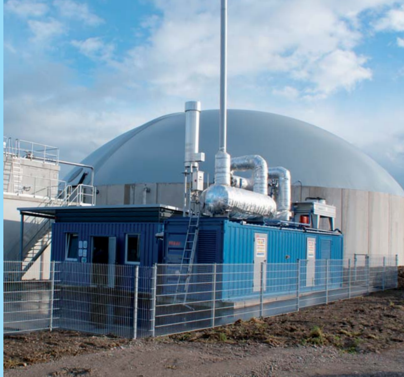
Biogasanlage begab in Bätterkinden mit 330 kWel. BHKW-Modul Bildquelle: sol-E Suisse AG
